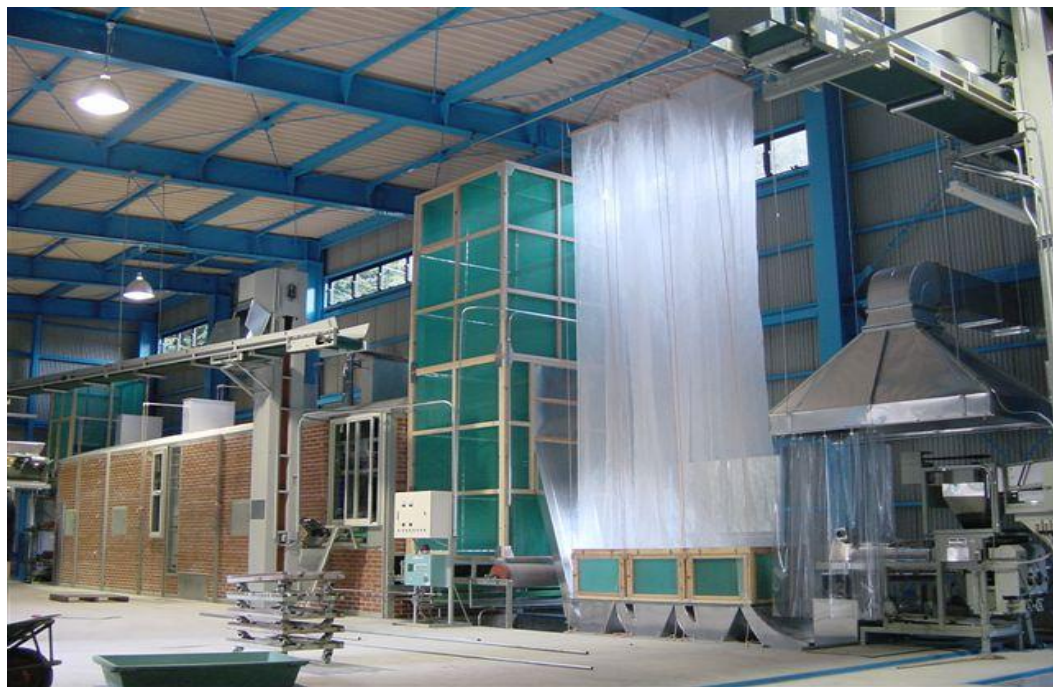
蒸工程～碾茶乾燥爐全景
